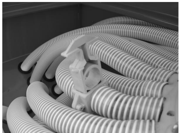
Рис. 34. Механический клапан установлен на распределителе
