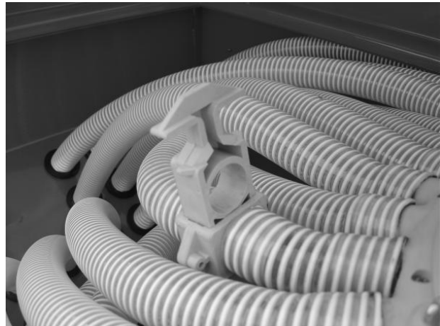
Rys. 34 mechaniczna kłapa namontowana na rozdzielaczu
